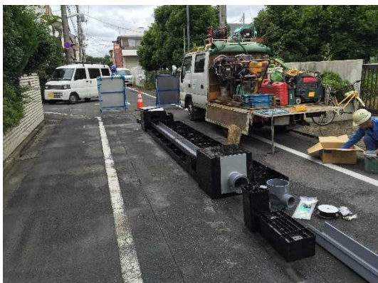
写真 3-3 雨水貯留・浸透施設の整備状況
