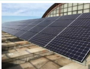
太陽光発電設備 (市民総合体育館)
