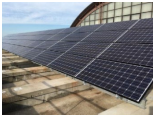
太陽光発電設備(市民総合体育館)
